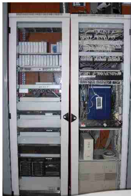
Rack de comunicaciones
